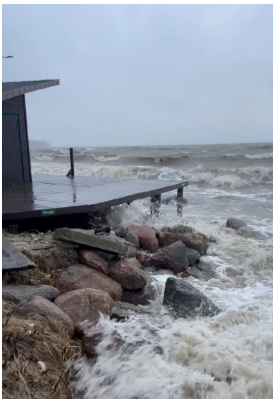
Ansøgers indsendte foto af højvandssituation fra 2019
