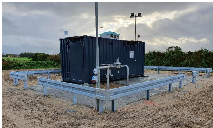
Figur 9 - Foto som viser eksempel på en BMR-station (20 fod-container)
