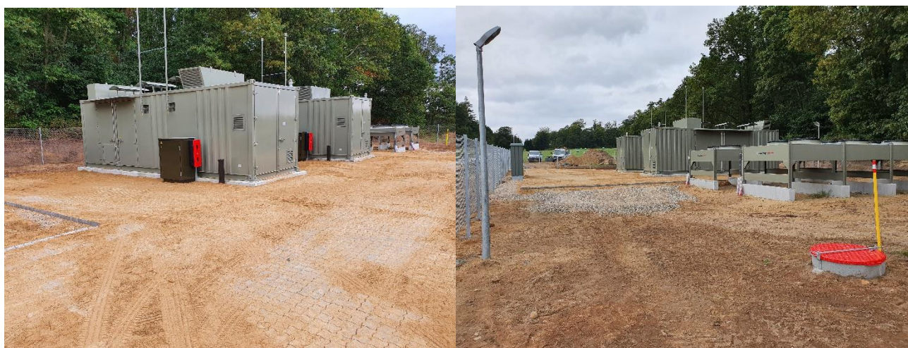
Figur 10- foto til venstre viser 2 kompressor-containere med tilhørende el-skab (foran) og kølere (bagerst). Foto til højre viser køleanlæg (forrest) og 2 kompressor-containere og el-skab til venstre (mod hegnet).
