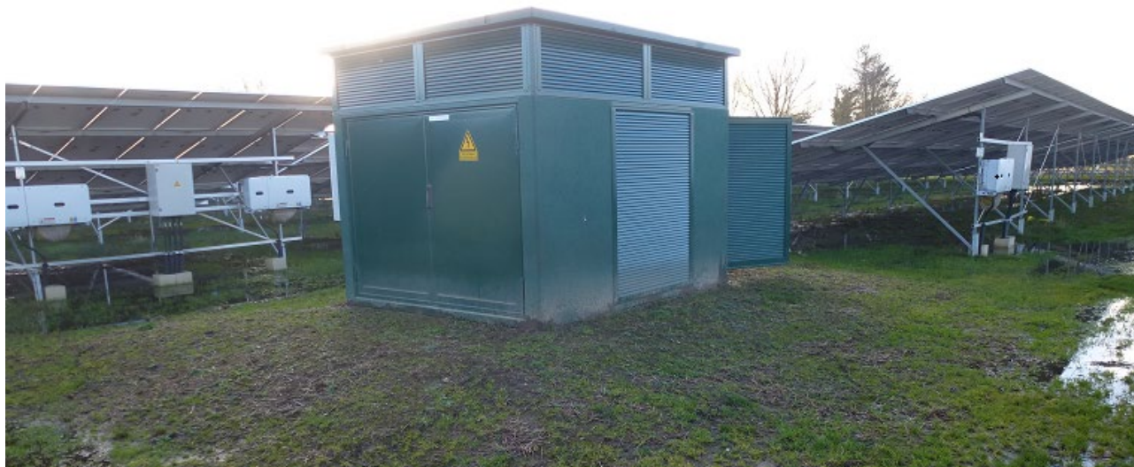
Figur 5-6 Eksempel på en af de små transformatorstationer (fra et andet projekt).
