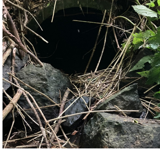
Rørlagt overkørsel med fald ud af udløbet, Skelbæk. Ca st. 1150
