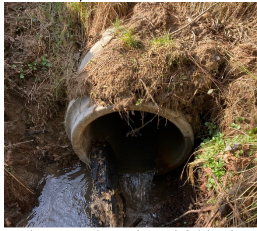
Rørlagt overkørsel med fald ud af røret. Spærring for faunaens fri passage. Ca. st.2280
