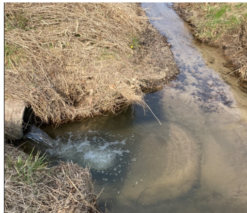
Udløbet af Skelbæk i Rårup Å, Her er et stort fald ud af røret, og derfor en faunaspærring. Ca. st. 2790
