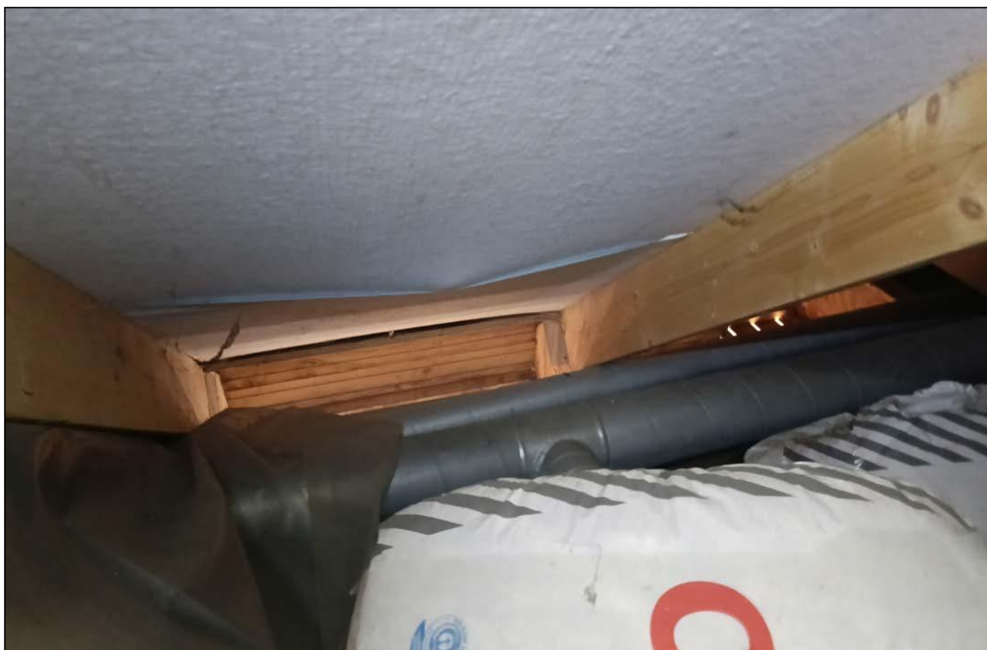
Foto 5. Adgang til det fri gennem tagudhæng på Hesselballevej 20, hvor der potentielt kan flyve flagermus ind på loftet.
