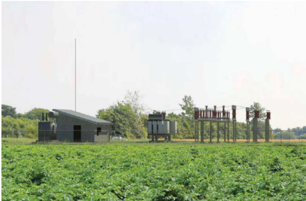
Figur 5.3: Eksempel på step-up transformer med tilhørende 15 meter høj lynafleder omkranset af trådhegn.
