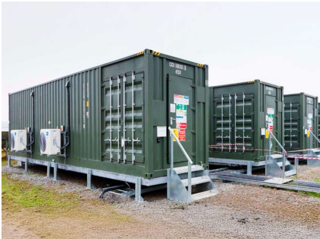
Figur 5.4: Foto der viser et eksempel på et batterianlæg bestående af container moduler monteret på en underliggende stålramme båret på punktfundamenter.
