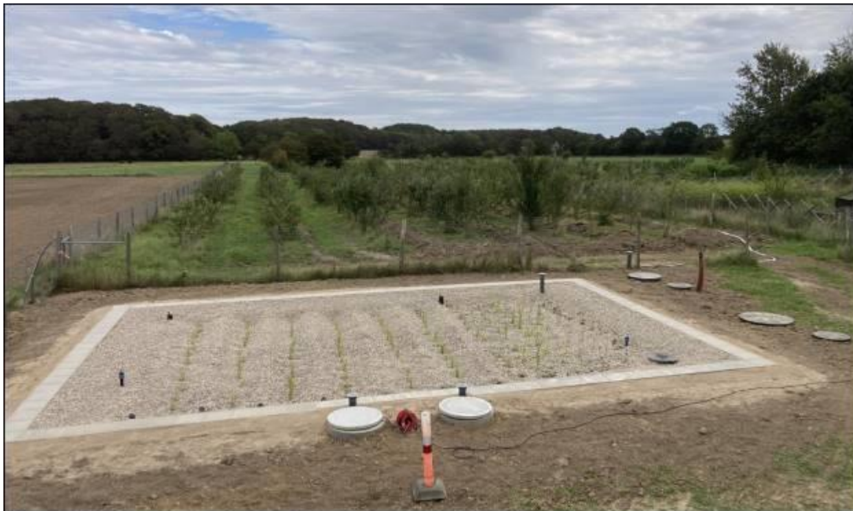
Figur 3 , viser et eksempel på, hvordan et beplantet filteranlæg kan se ud. Det viste billede er fra ansøgningsmateriale indsendt den 14. marts 2023
