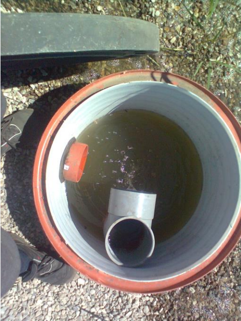
Figur 3. Foto af en højderegulerings- og prøveudtagningsbrønd på afløbsside inde i anlægget.
