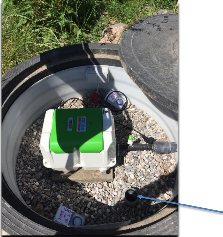
Figur 4. Foto af brønd med belufter, timer og gråt rør til 'indsugningshætte' (ved pilen)
