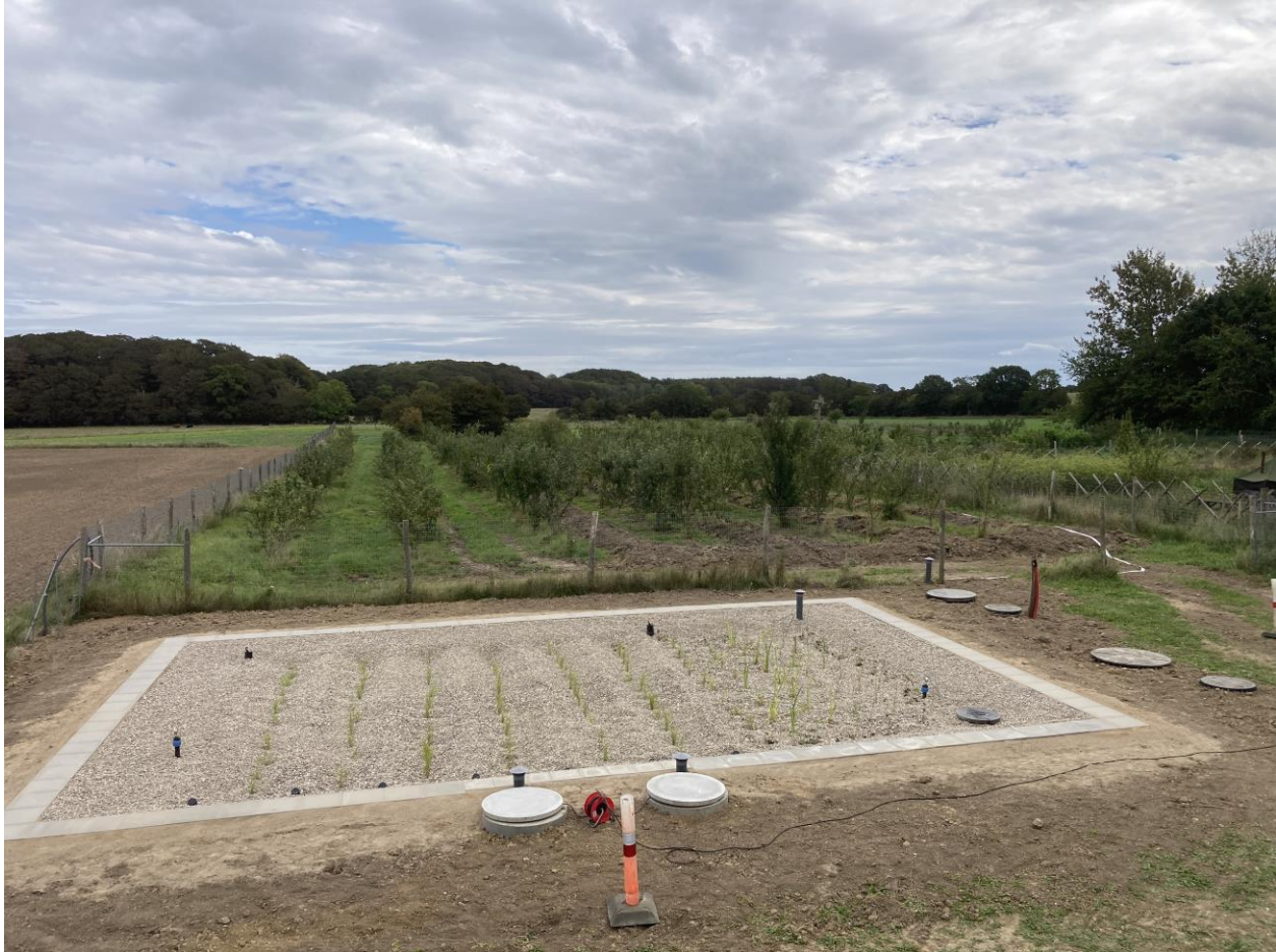
Foto 1: Et beplantet filteranlæg med efterfølgende nedsivning i faskine (mellem frugttræer).
