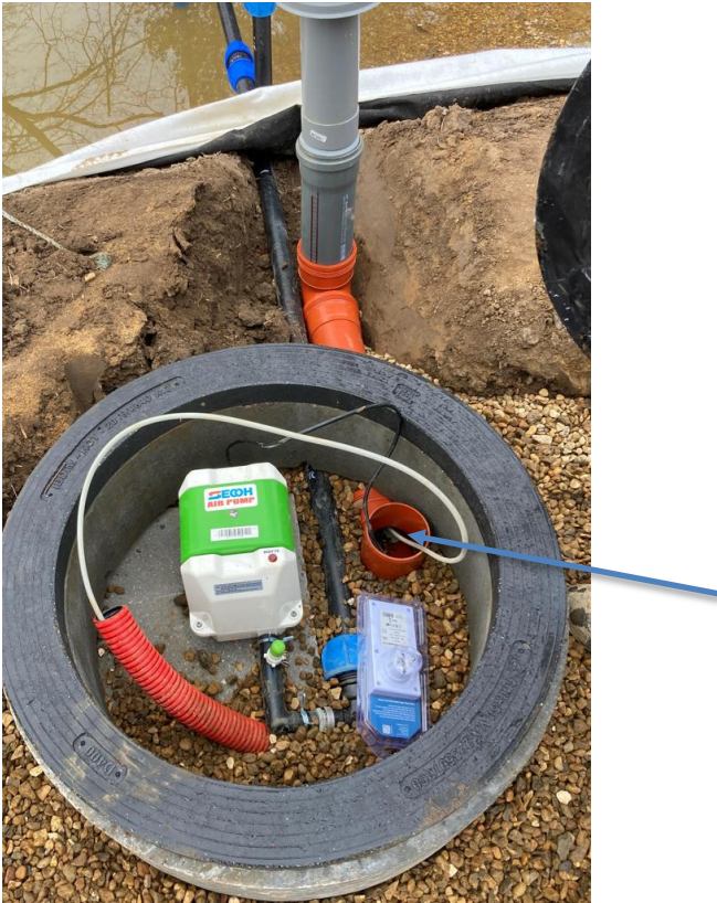
Figur 5. Foto af brønd med belufter, timer og orange rør til 'indsugningshætte' (ved pilen)
