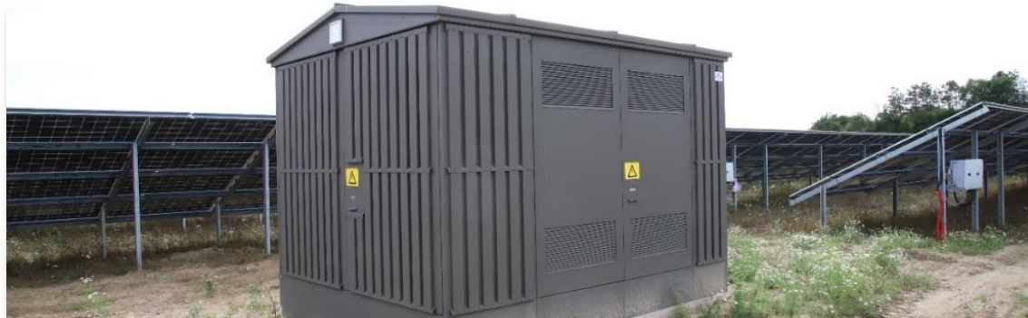
Billede 7: Solceller på stativer i baggrunden. Den hvide boks til højre er en inverter. I forgrunden ses en fordelingstransformer.
