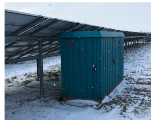
Foto - Eksempel på transformerkiosk med fordelingstransformere.
