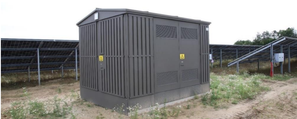
Billede 3: Solceller på stativer i baggrunden. Den hvide boks til højre er en inverter. I forgrunden ses en fordelingstransformer.
