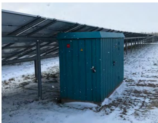
Foto - Eksempel på transformerkiosk med fordelingstransformer.
