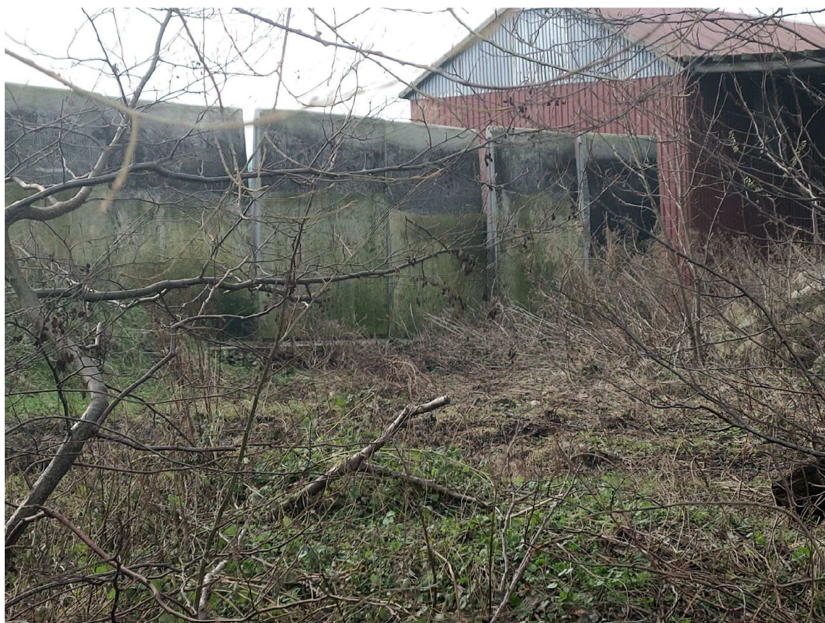
Betonelementerne er placeret mindre end 10 meter fra skel 15/12-2023.
