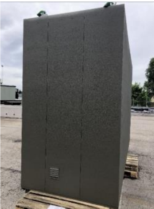
Figur 3-9 Eksempel på sekundær koblingsstation.
