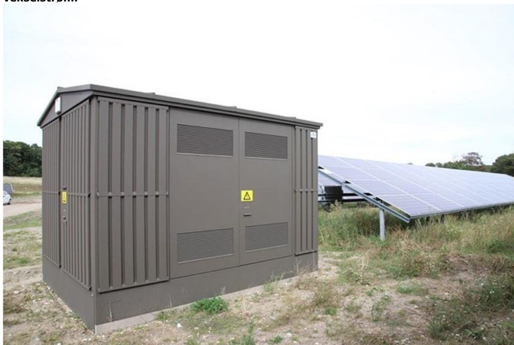
Figur 3-5 Eksempel på en teknikbygning. Her en typisk transformerkiosk. Der etableres cirka én transformerkiosk per 3 MW installeret solcellekapacitet.
