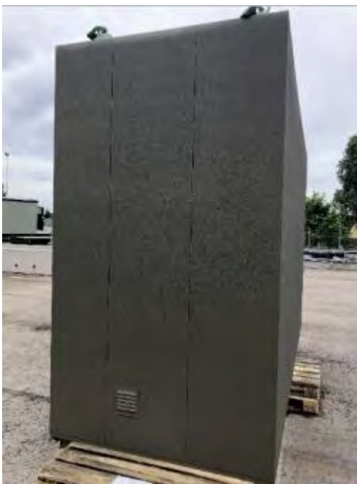
Figur 3-9 Eksempel på sekundær koblingsstation.
