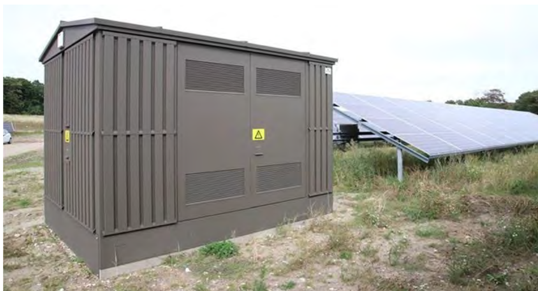
Figur 3-5 Eksempel på teknikbygning. Her en typisk fordelingstransformer.
