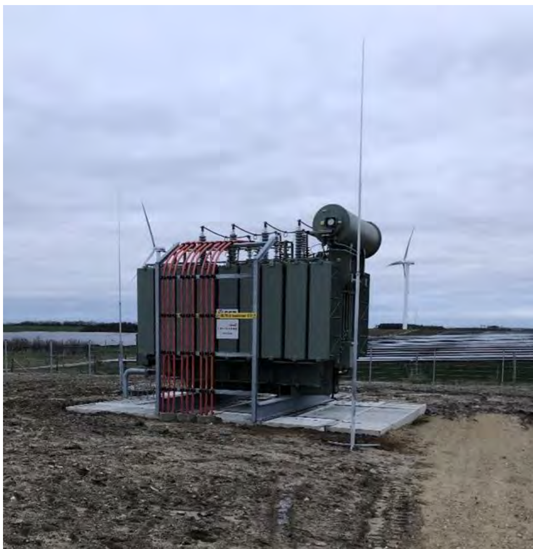
Figur 3-9 Eksempel på lynafledere og effekttransformer.
