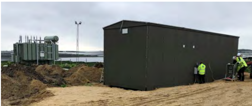
Figur 3-7 Eksempel på effekttransformer tv og primær koblingsstation.
