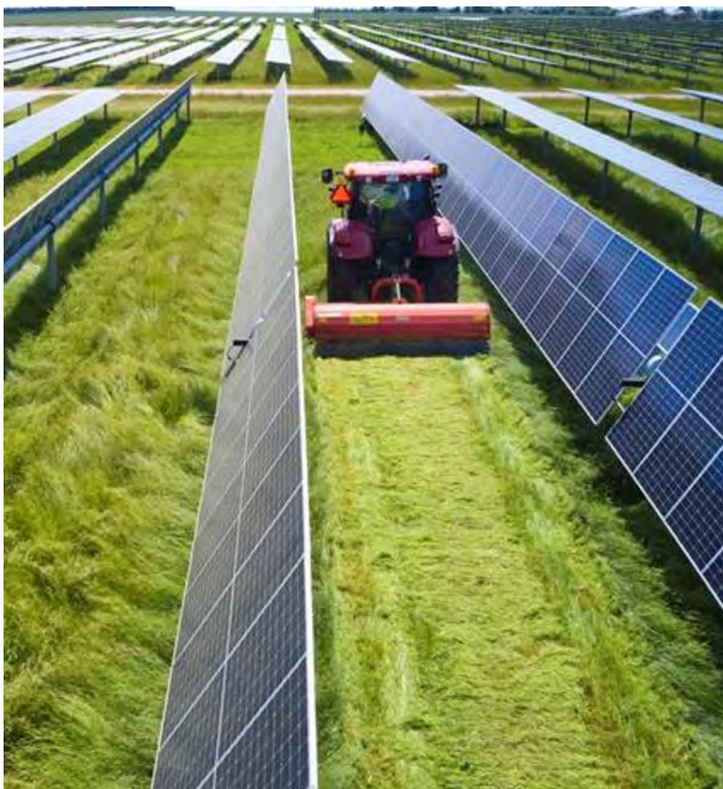
Figur 3-3 Eksempel på solcellepaneler på trackerstativer.
