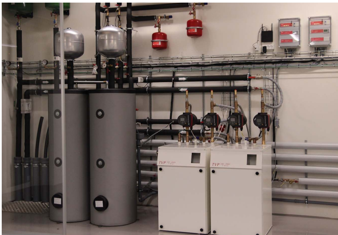
Figur 3-4 De udviklede kommunikationsprotokoller er dels langtidstestet på ca. 100 installationer og dels testet på Insero Energys demoanlæg på Green Tech Centeret ved Vejle. Her er det muligt at styre varmpumperne ikke bare efter den tyske SG Ready forskrift, men også direkte ændre set-punkter eller omdrejningstallet på kompressoren.
