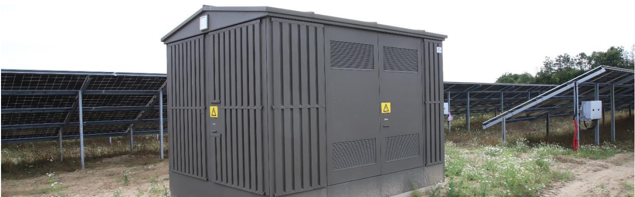
Figur 2: I dette layout sidder invertere som en hvid kasse under solpanelerne og fordelingstransformer ses i forgrunden.
