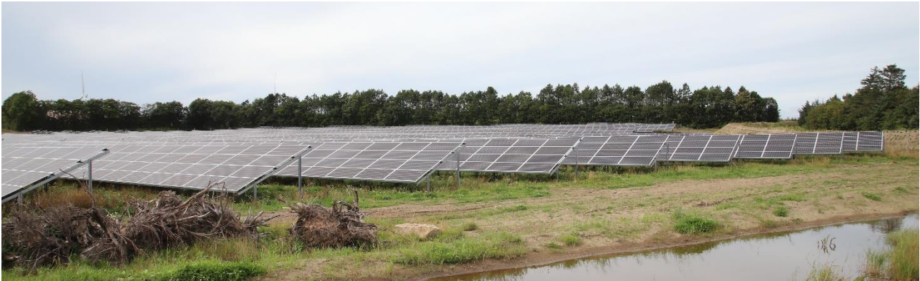
Figur 1: Solceller monteret på faste stativer
