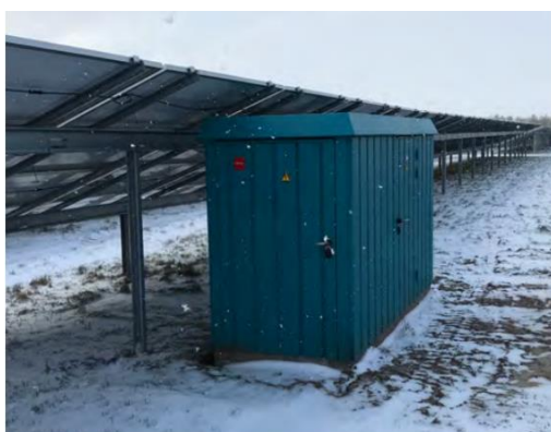
Foto - Eksempel på transformerkiosk med fordelingstransformer.
