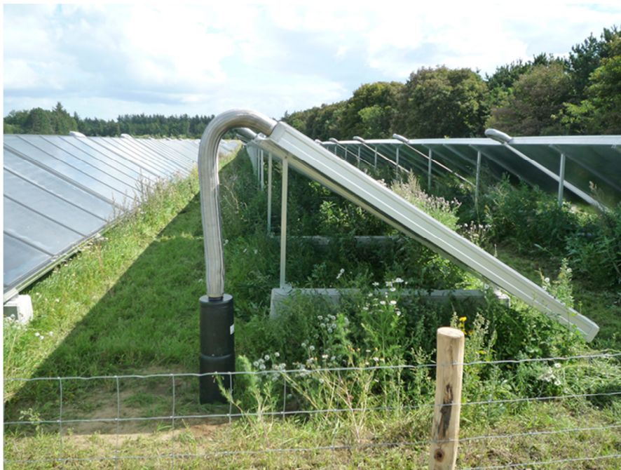
Billede fra idriftsat solvarmeanlæg
