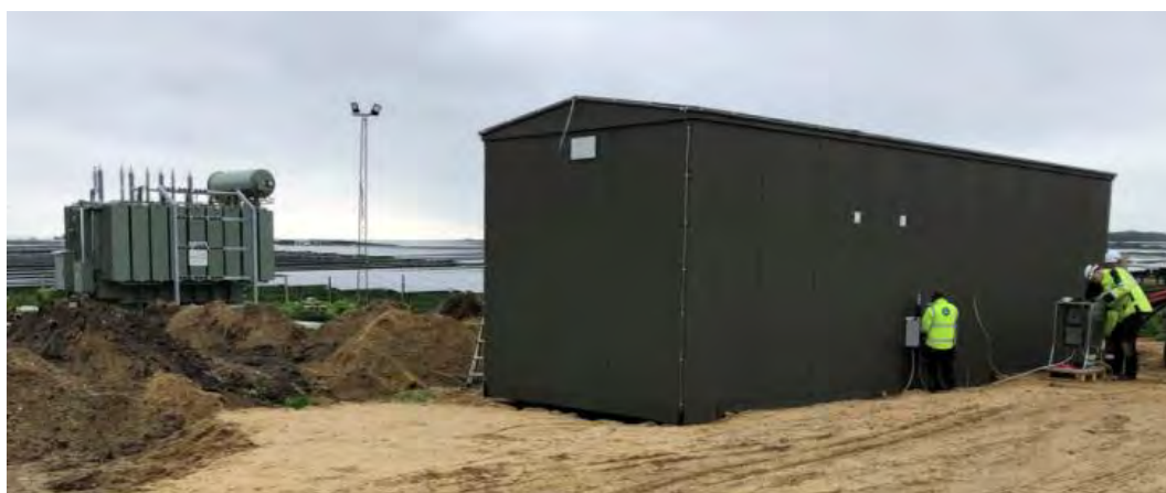
Figur 3-7 Eksempel på effekttransformer tv og primær koblingsstation.
