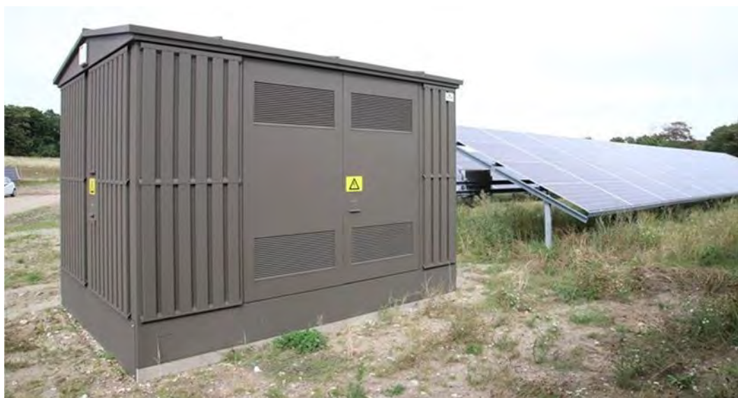
Figur 3-5 Eksempel på teknikbygning. Her en typisk fordelingstransformer.
