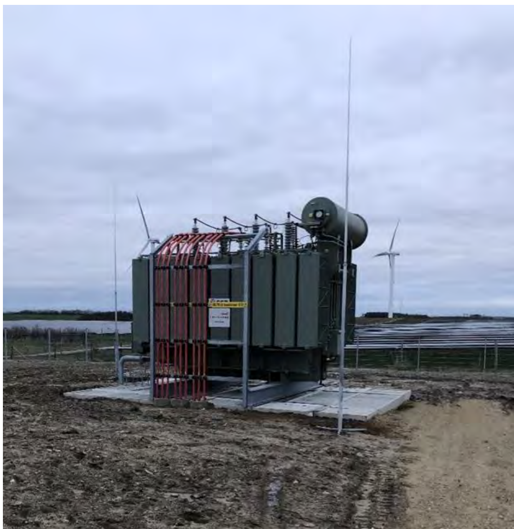
Figur 3-9 Eksempel på lynafledere og effekttransformer.
