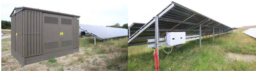
Figur 1-2 Eksempel på teknikbygning. Her en typisk fordelingstransformer tv. Eksempel på inverter, som placeres under solcellerne th.
