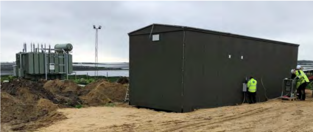
Figur 3-8 Eksempel på effekttransformer tv og primær koblingsstation th.
