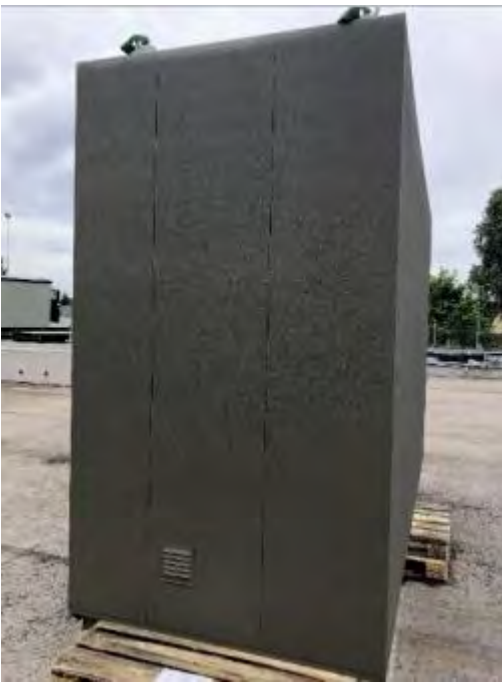
Figur 3-9 Eksempel på sekundær koblingsstation.
