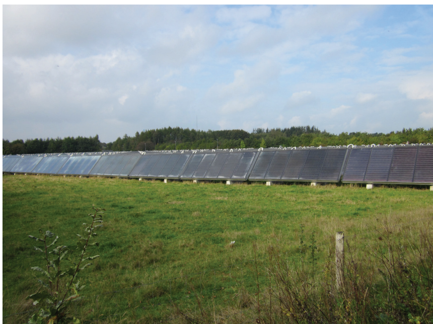
Eksisterende solfanger anlæg
