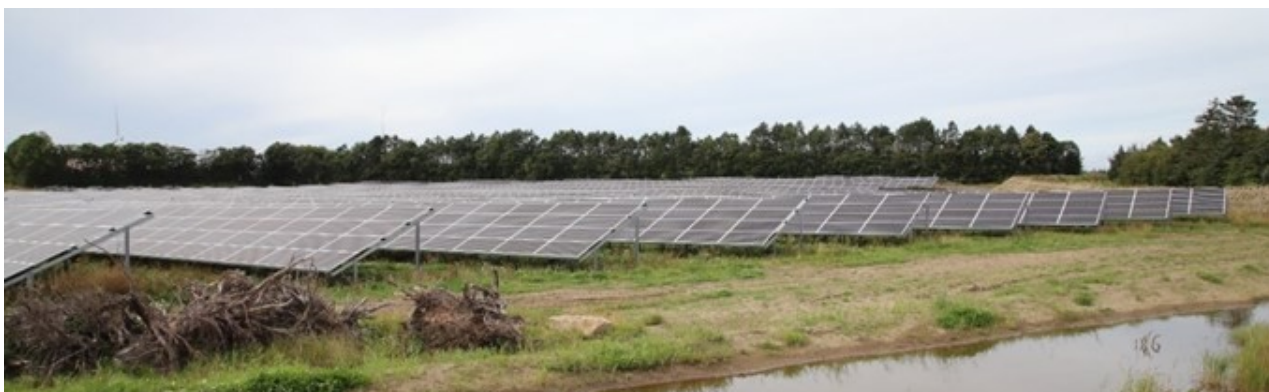
Foto af solcellepaneler på faste stativer.
