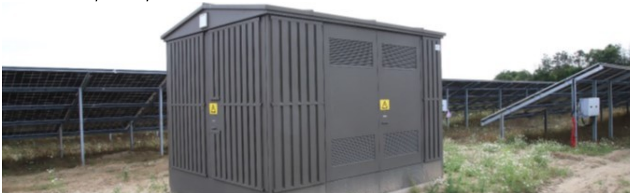
Eksempel på typisk fordelingstransformer. De hvide kasser under solcellerne er invertere, som omdanner jævnstrømmen til vekselstrøm.
