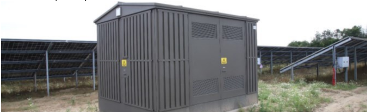
Eksempel på typisk fordelingstransformer. De hvide kasser under solcellerne er invertere, som omdanner jævnstrømmen til vekselstrøm.
