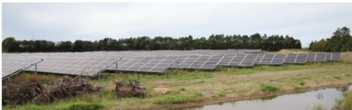
Figur 2.1: Solceller monteret på faste stativer
