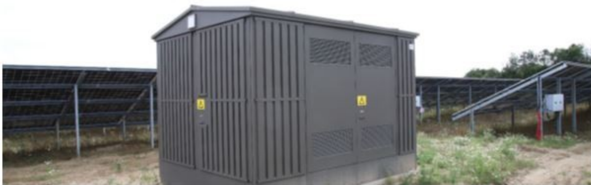
Figur 2.2: De hvide kasser under solcellerne er invertere, som omdanner jævnstrømmen til vekselstrøm og eksempel på teknikbygning, her en typisk fordelingstransformer.
