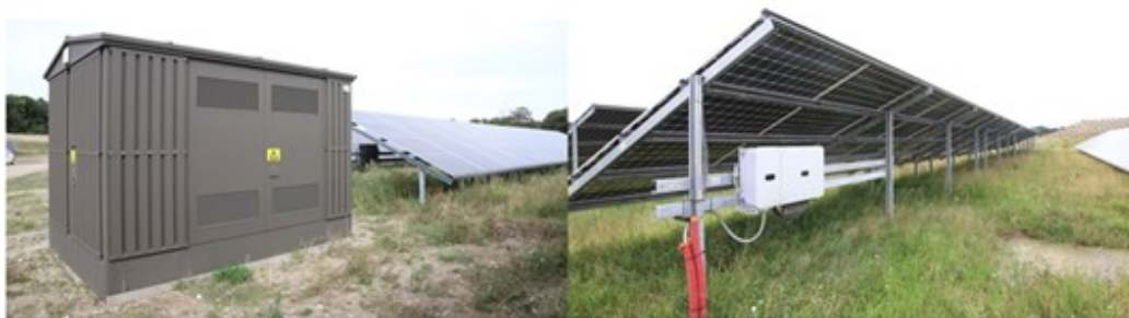
Figur 1-2 Eksempel på teknikbygning. Her en typisk fordelingstransformer til venstre. Eksempel på inverter, som placeres under solcellerne til højre.
