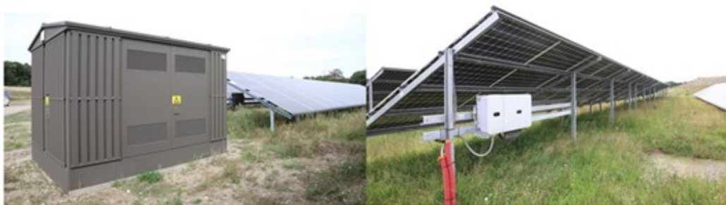
Figur 1-2 Eksempel på teknikbygning. Her en typisk fordelingstransformer til venstre. Eksempel på inverter, som placeres under solcellerne til højre.
