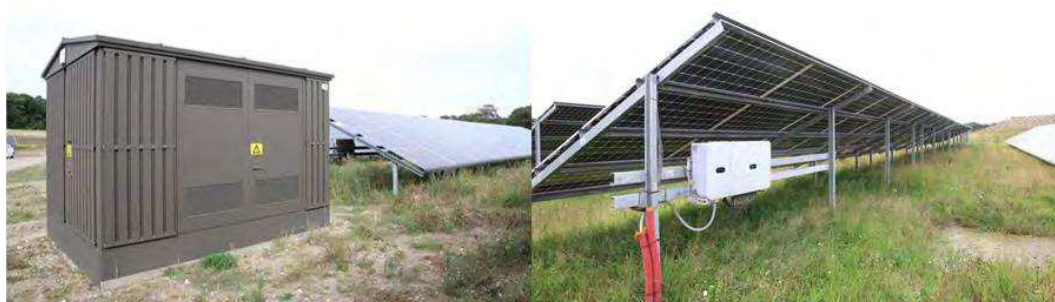
Figur 1-2 Eksempel på teknikbygning. Her en typisk fordelingstransformer tv. Eksempel på inverter, som placeres under solcellerne th.
