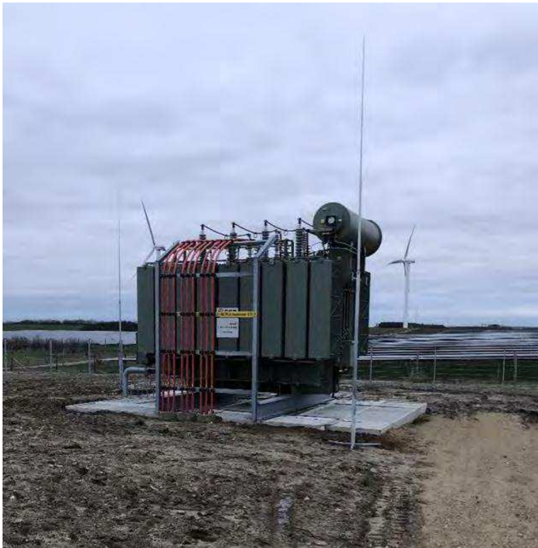
Figur 3-9 Eksempel på lynafledere og effekttransformer.
