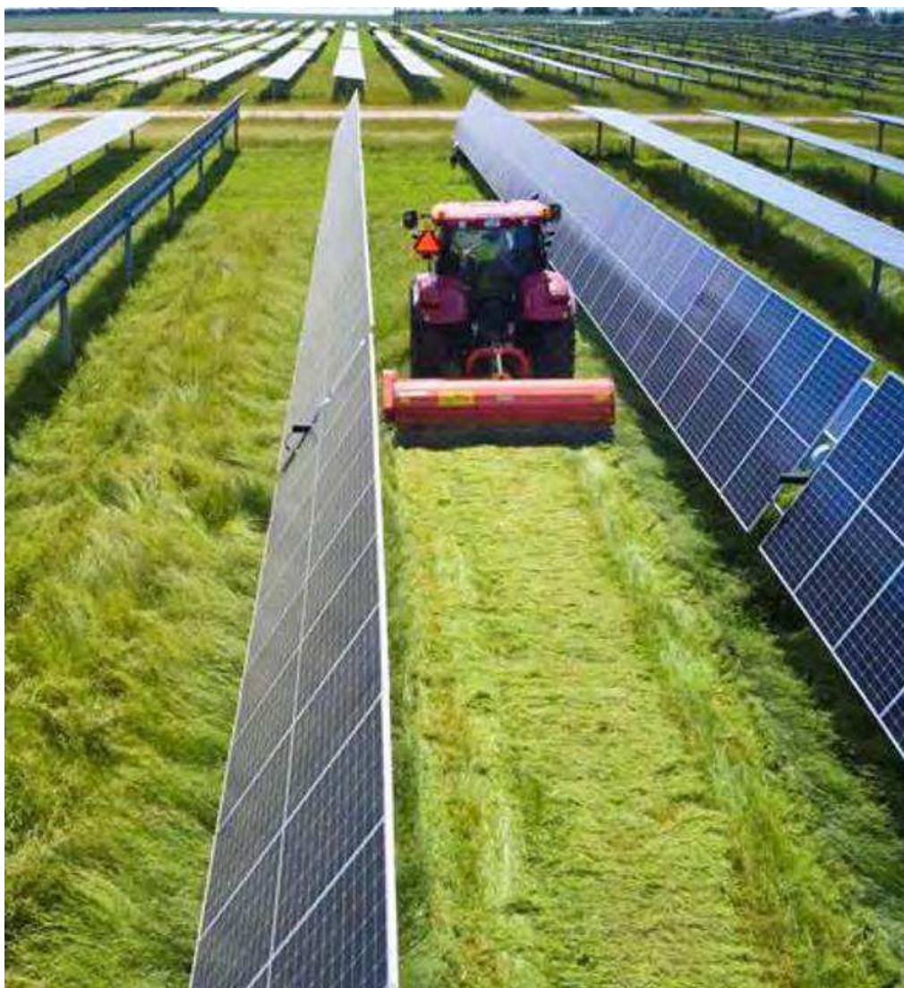
Figur 3-3 Eksempel på solcellepaneler på trackerstativer.
