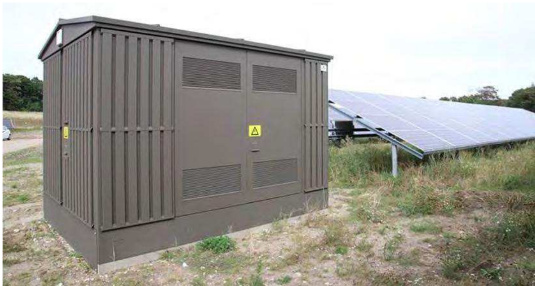
Figur 3-5 Eksempel på teknikbygning. Her en typisk fordelingstransformer.
