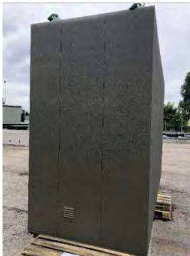
Figur 3-8 Eksempel på sekundær koblingsstation.
