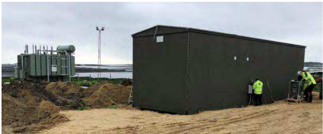
Figur 3-7 Eksempel på effektransformer tv og primær koblingsstation.
